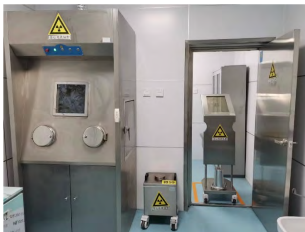
给药注射室门、注射车、通风橱和废物桶等处电离辐射警告标志
