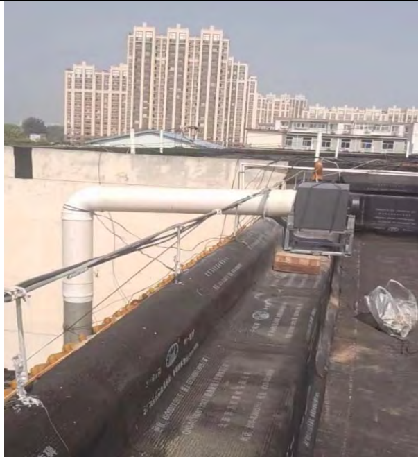
独立排风管道
