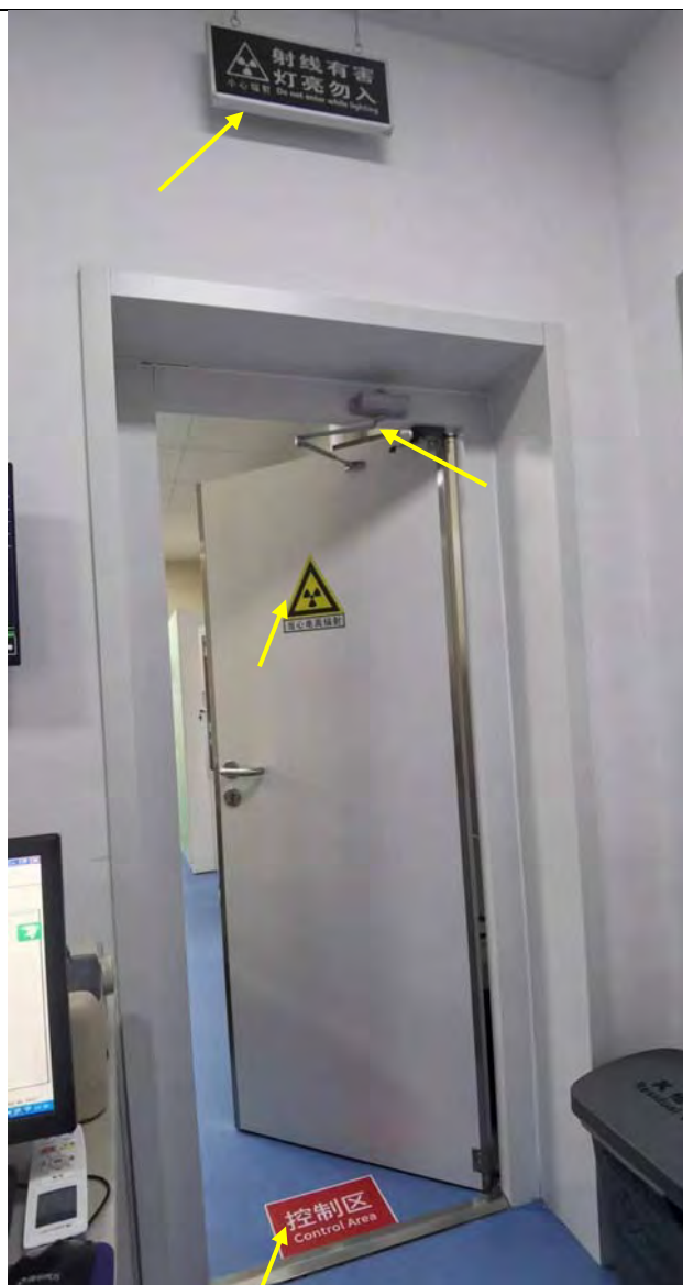
控制室防护门设置的放射性标志和中文警示说明、“射线有害 灯亮勿入”警示灯、闭门器以及分区标志
